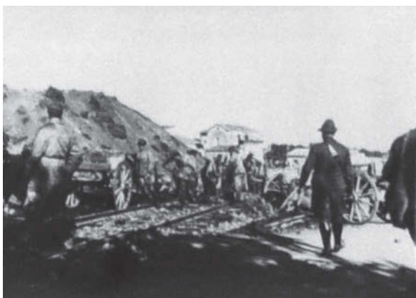
Foto 11. Genieri del Rgt. Ferrovieri provvedono ad armare il raccordo provvisorio ai margini.
